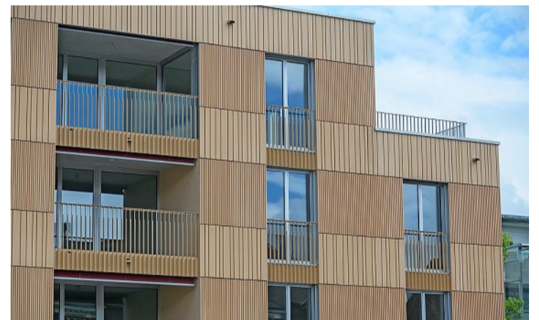
Die Fassade wird aufwendig mit Keramikelementen verkleidet und erreicht dennoch nicht den notwendigen Detailreichtum.
