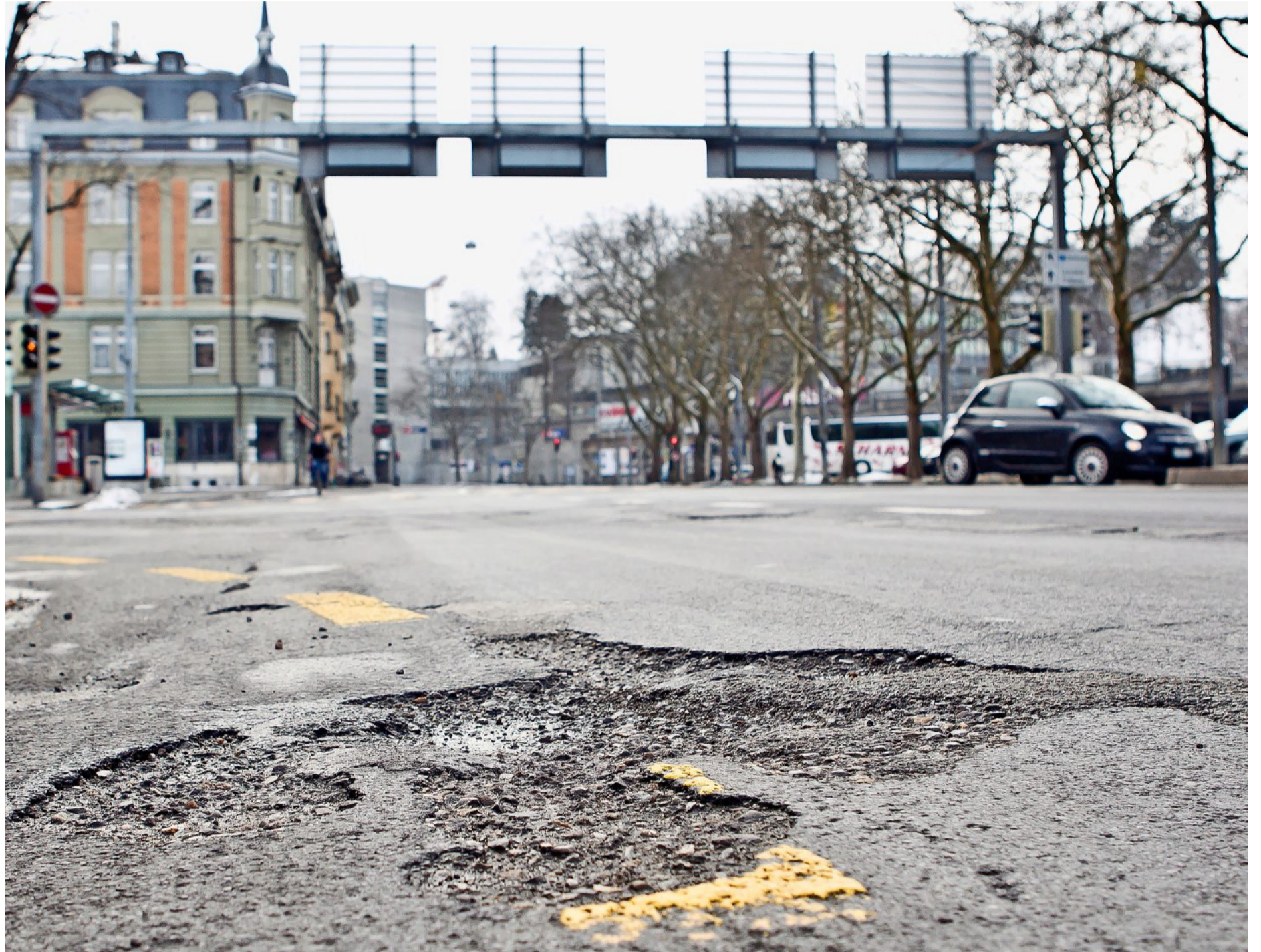
Schäden im Belag entstehen gerade bei Brücken oft, wie hier bei der Lorrainebrücke in Bern. Foto: Tobias Anliker (Archiv)
