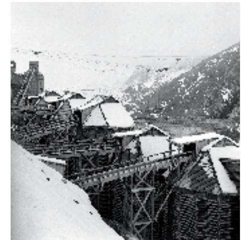
Zementaufbereitungsanlage der Baustelle Oberaar, 1952. (Fotos: Anita Niesz, Fotostiftung Schweiz, 2000.50.328 und 2017.40.003)
